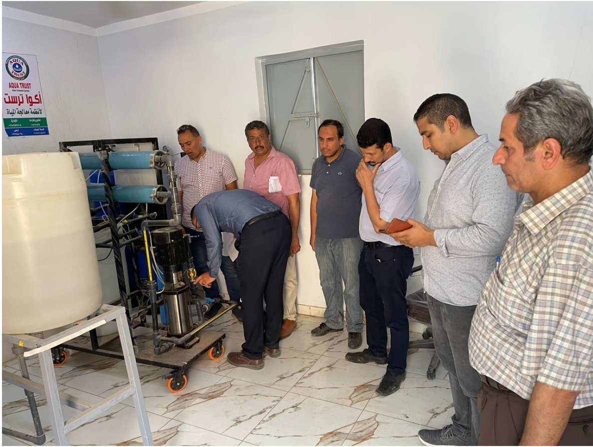
صورة رقم (13) لجنة الاستلام النهائي داخل غرفة التحكم للاطمئنان علي سلامة تشغيل الأجهزة بكفاءة وكتابة ملاحظاتها
